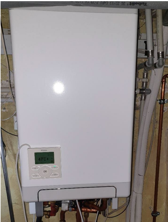
Gashybridunit (inde del og gasfyr) i villaens kælder Foto: DGC
